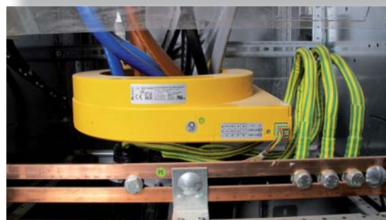
Messung allstromsensitiv Verbraucheranlagen
