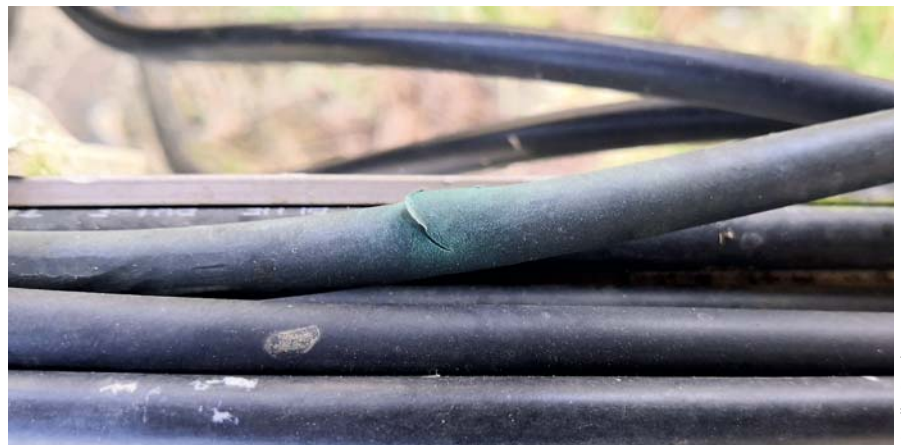
Bild 4: Beschädigte Isolierung eines Stringkabels
